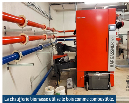
La chaufferie biomasse utilise le bois comme combustible.
