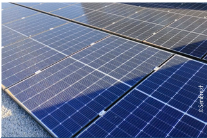
L'énergie produite par les panneaux photovoltaïques en toiture de l'internat sera autoconsommée par l'établissement.
