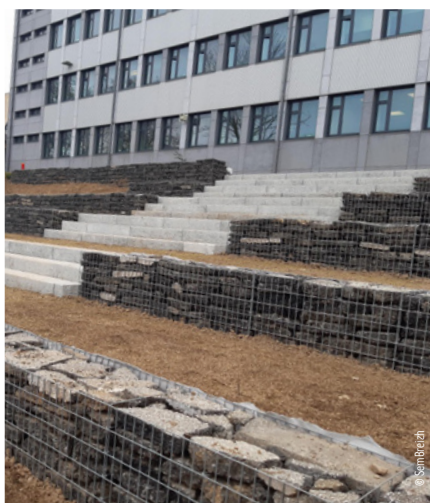
Le bitume retiré pour désimpermeabiliser la cour est réemployé pour composer les gradins extérieurs.
