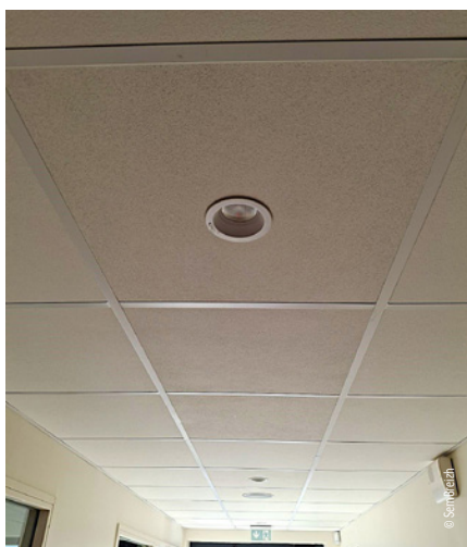
Les faux-plafonds récupérés en parfait état sur un ancien bâtiment ont trouvé leur place dans les futurs couloirs et salles de classe.
